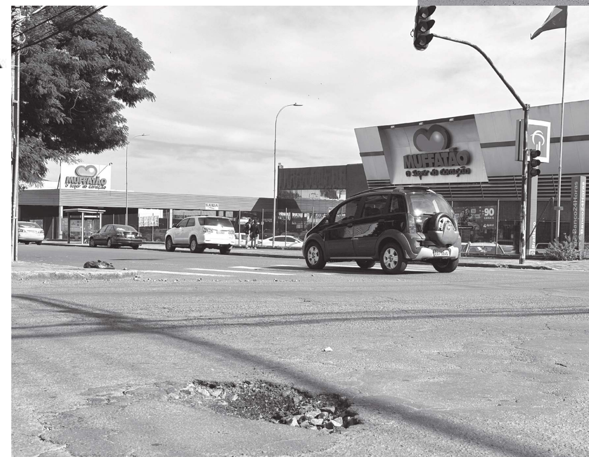
População reclama das ruas cheias de buracos
