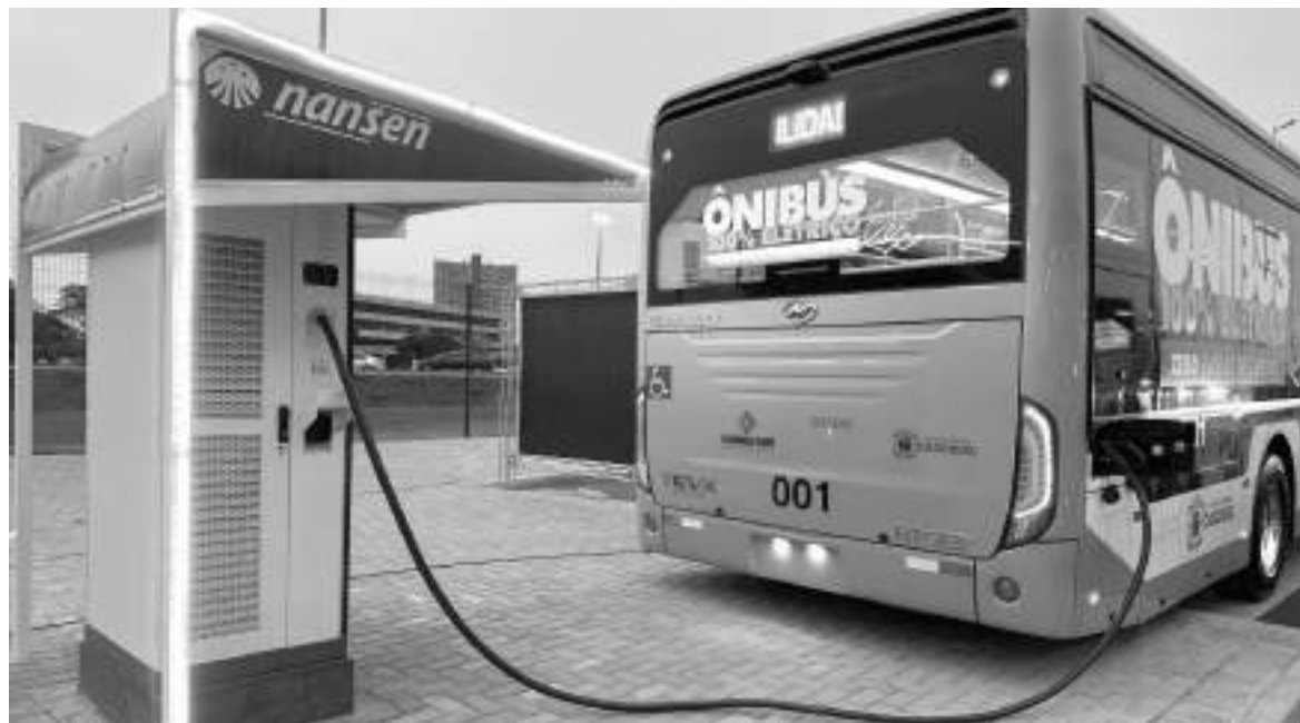
Estrutura de carregamento instalada para atender a frota de ônibus elétricos
